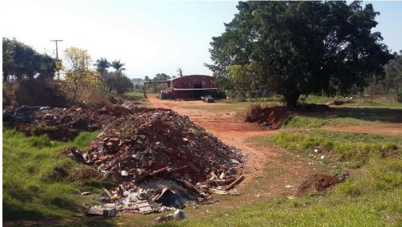
Imagem 14: Descarte irregular de resíduos da construção civil.
